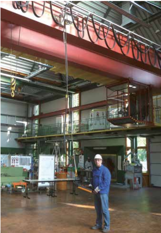
Bild 3-1: Krananlage, die wahlweise vom Führerhaus oder von Flur aus gesteuert werden kann
