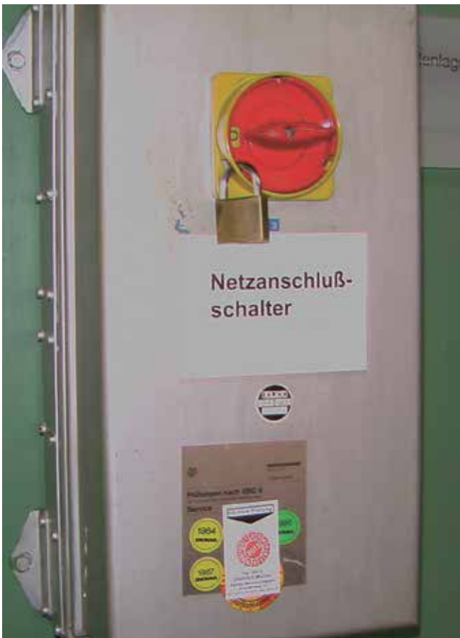
Bild 7-2: Der Kranführer schaltet den Netzanschlussschalter aus
