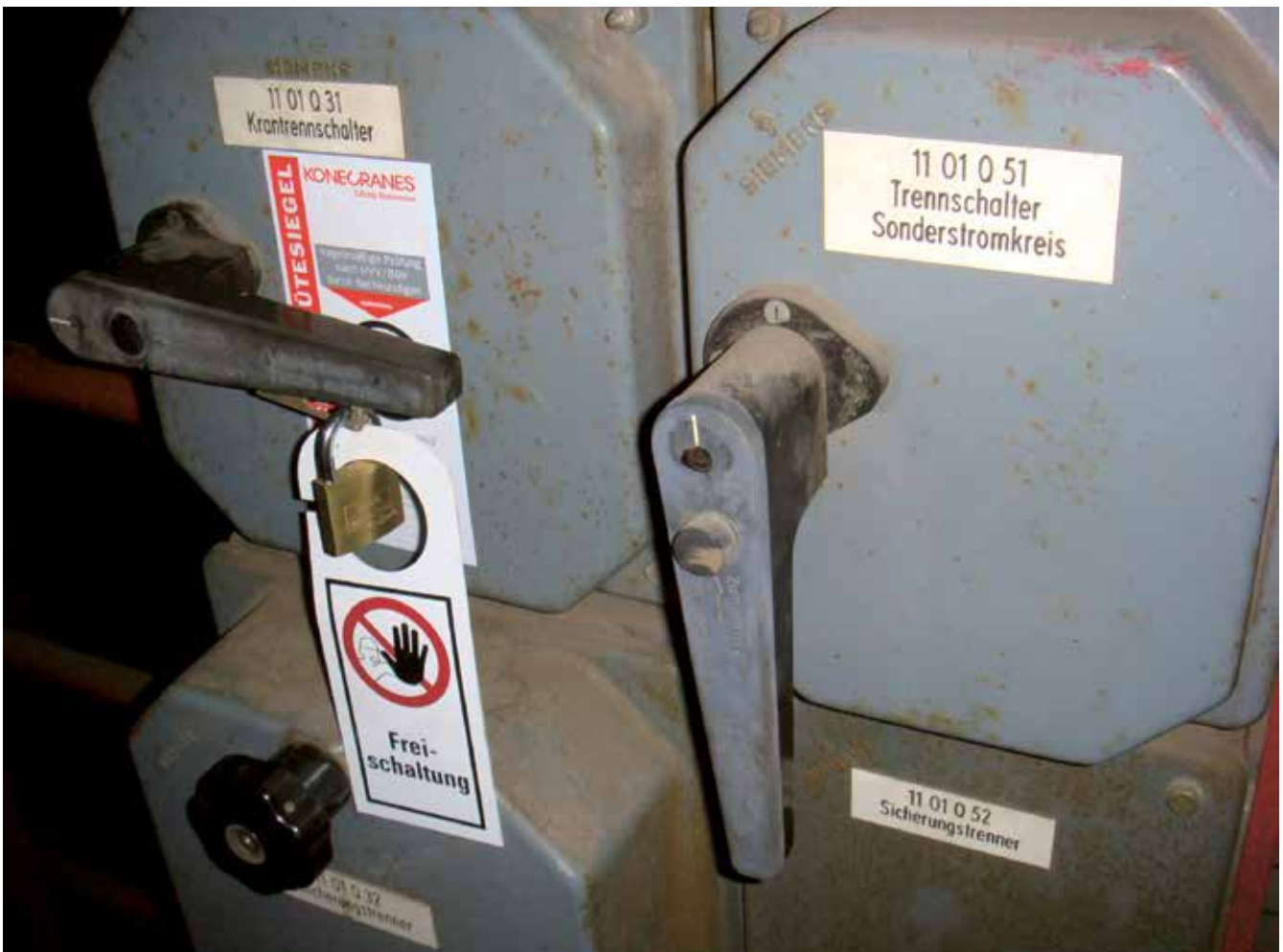
Bild 8-1: Der Kranrennschalter ist ausgeschaltet und durch ein Vorhängeschloss gegen das irrtümliche oder unbefugte Einschalten gesichert
