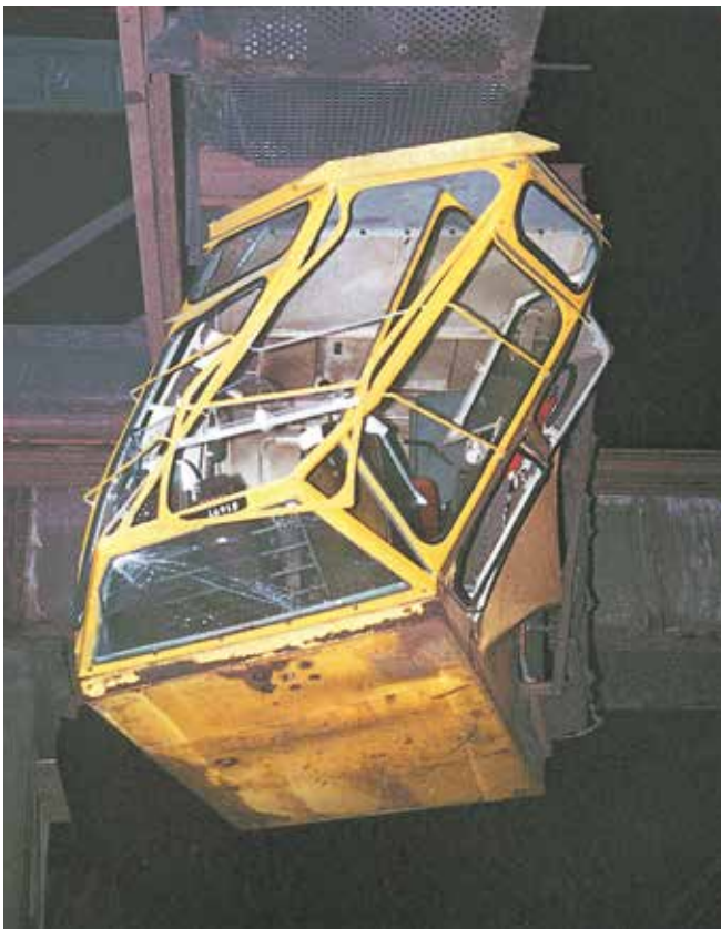
Bild 4-7: Bei der Kranfahrt stieß die Unterkante des Führerhauses an zu hoch gelagertes Material
